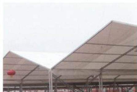
排水槽 Rain gutter
